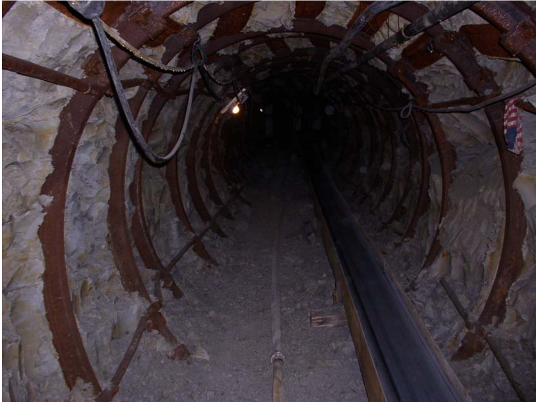
Abbildung 3-1: Hauptstrecke Grube Lengemann mit vierteiligen, nachgiebigen Stahlbogenausbau im Ringschluss
